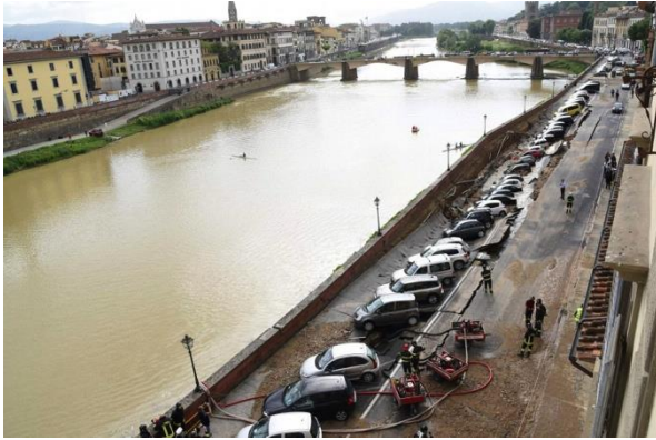
Figure 9 Arno Levee collapse - source Repubblica.it
